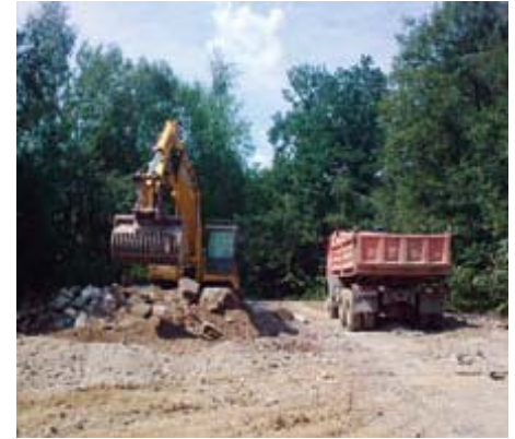
Ökokontomaßnahme Eppendorf der SLS, Entsiegelung von Lagerflächen und Gebäuden im Wald mit Initialpflanzung
